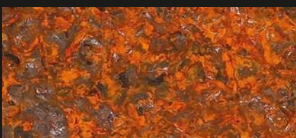
Sin tratamiento de protección contra la corrosión
